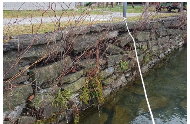
Beschädigte Ufermauer durch Knöterich-Bewuchs
