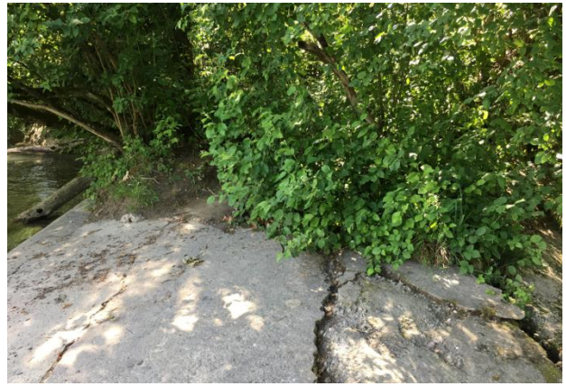
Abb. 2: Farhubel: Sogar auf Betonflächen bildet sich mit der Zeit eine kleine Bodenschicht.
