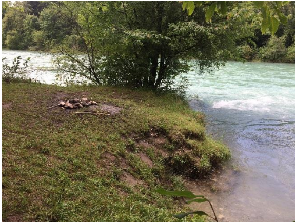
Beschädigte Buhne mit Feuerstelle.
