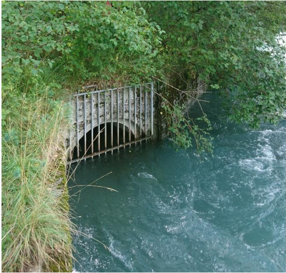
Auslaufbauwerk der ARA Unteres Kiesental.
