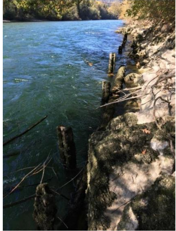
Zustand des rechtsufrigen Uferschutzes im Projektperimeter (Quelle: OIK II, TBA Kanton Bern).
