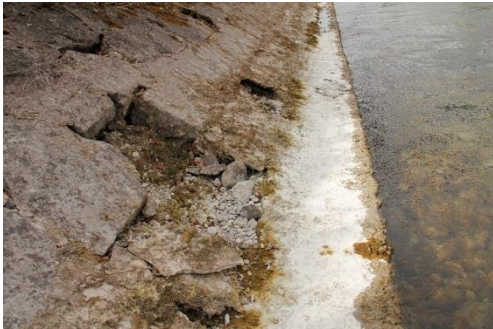
Abbildung 18: Fehlender Mauerstein in Uferverbau.
