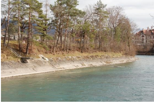
Abbildung 16: Abplatzungen und Bewuchs an Betonplatten im Bereich Waffenplatz, Schwäbis.
