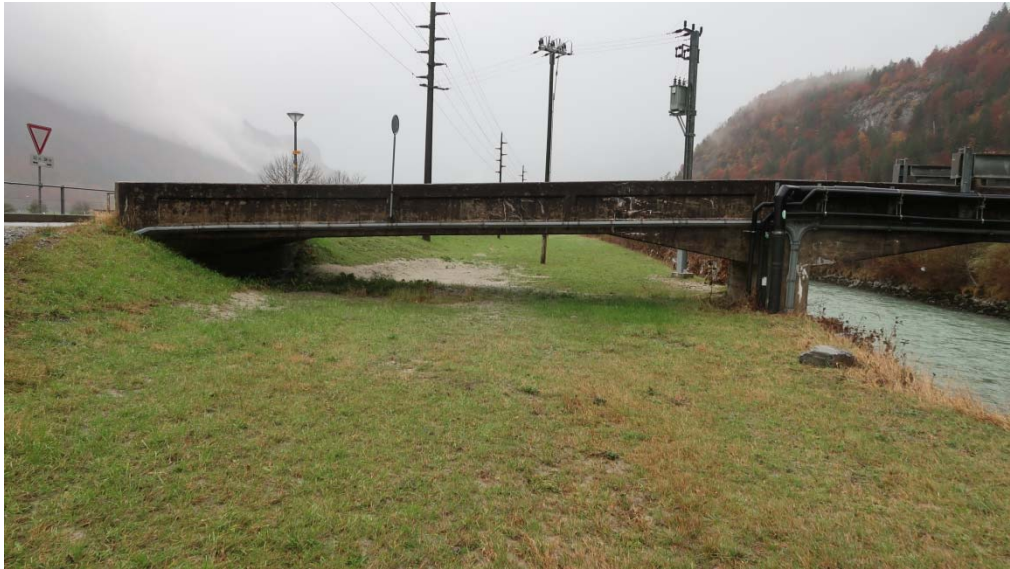
Alte Hirssibücke mit aufgehängten Werkleitungen soll ersetzt werden.
